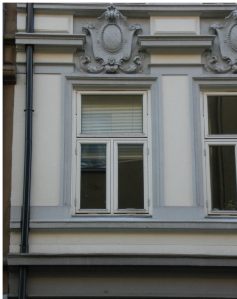
Ny, dårlig erstatning av vindu i Dalsbergstien, med blant annet feil rammeinndeling.
